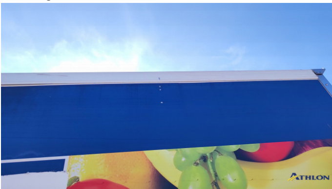
14. telaio del tetto - sinistro Graffio/Rigature
