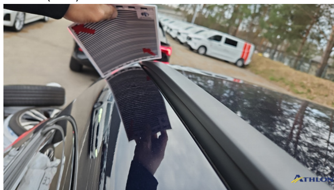
7. Dachrahmen - Rechts 1 Delle
