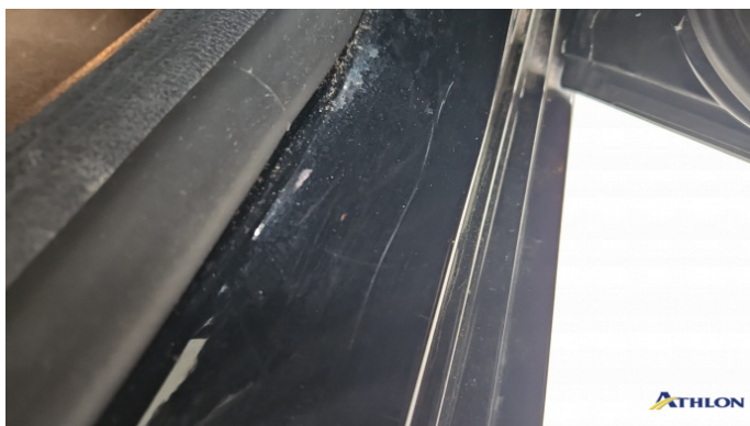
13. Türeinstieg Hinten - Rechts Kratzer
