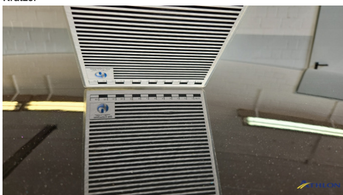
6. Dach 5 Dellen Nicht In Ordnung
