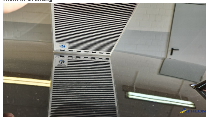
6. Dach 5 Dellen Nicht In Ordnung
