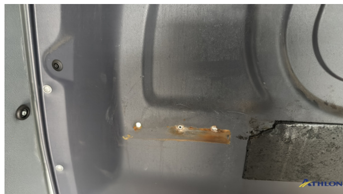
12. Parete divisoria cabina - PRM Graffio/Rigature
