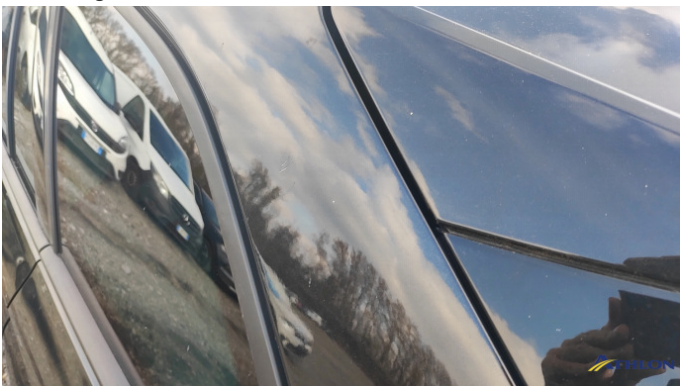
13. telaio del tetto - sinistro Graffio/Rigature
